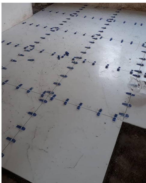
تعداد نامناسب کلیپس و گوه همترازکننده
